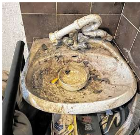
Dieses Waschbecken kann nicht mehr genutzt werden. Der Hof des Hauses diente als Toiletten-Ersatz.
